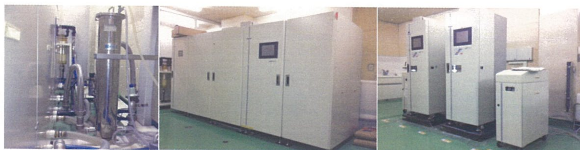
①プレフィルタ ②活性炭処理 ③軟水処理 ④逆浸透装置 ⑤多人数用透析液供給装置
